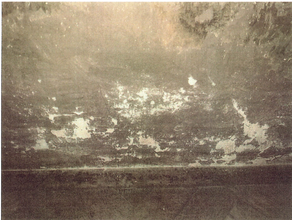
II. 1 Cela "tramwaj" 1. Niszczące działanie soli. Widoczne uszkodzenia. Ponadto widoczne zmiany w retuszach.
