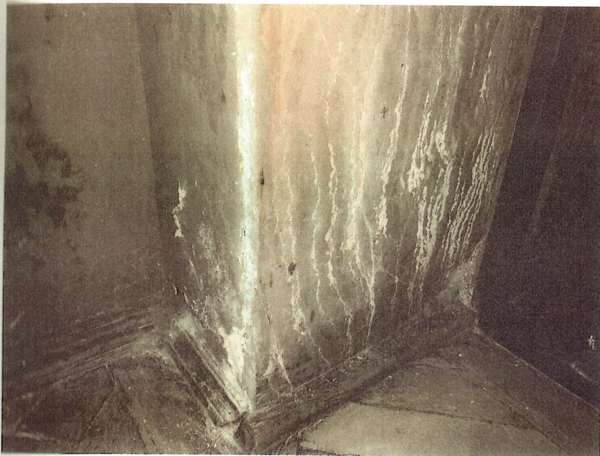
II. 2 Cella "tramwaj"2. Płyta kamienna - niszczące działanie soli.
