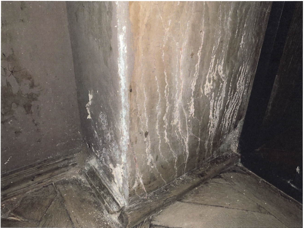
II. 2 Cella "tramwaj"2. Płyta kamienna - niszczące działanie soli.
