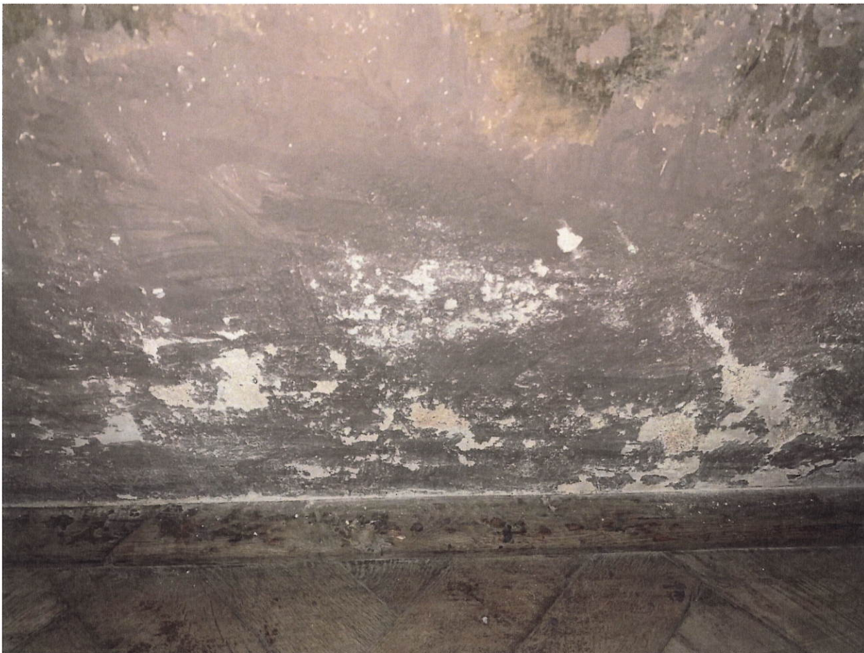
II. 1 Cella "tramwaj" 1. Niszczące działanie soli. Widoczne uszkodzenia. Ponadto widoczne zmiany w retuszach.
